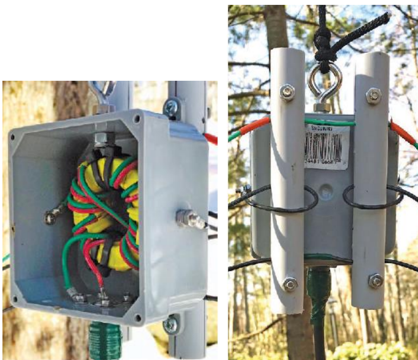
Fot. 1.1.5.3. Skrzynka przyłączeniowa z symetryzatorem i dwoma rozpórkami z PCW
